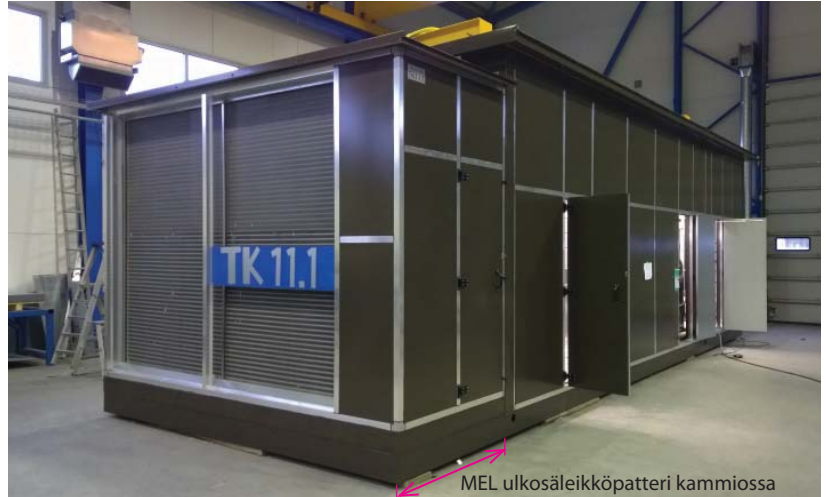
Kuvassa on HUS Meilahti keittiön kattokoje (4 kpl yhteensä) jonka ilmanottoaukon eteen on asennettu MEL ulkosäleikköpatteri erilliseen kammioon varusteineen.
